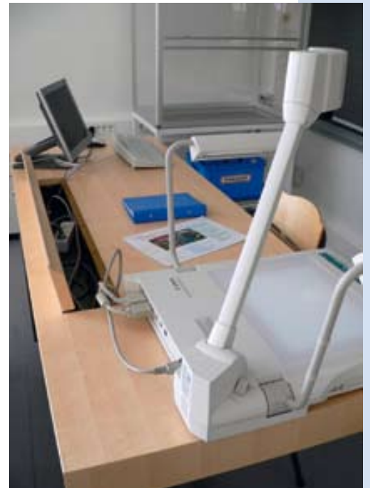
Lärarens bord: dokumentkamera (läskamera) och dator. AV-utrustning under bordsskivan, kablarna placeras under en lucka som kan stängas.
